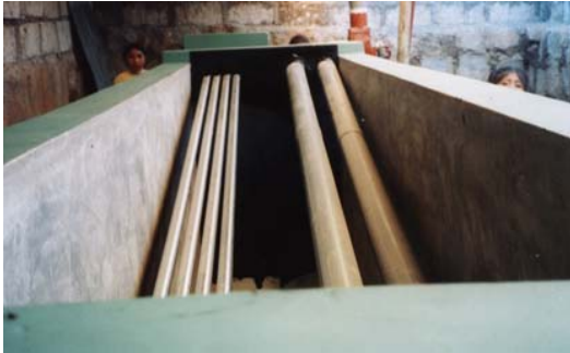
Tubos de Enfriamiento(4) y de Retorno (2) Sumergidos en el tanque de enfriamiento.
