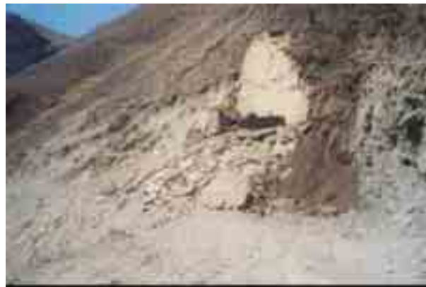
Zona de derrumbes en el camino entre Untuca y Llactapata
