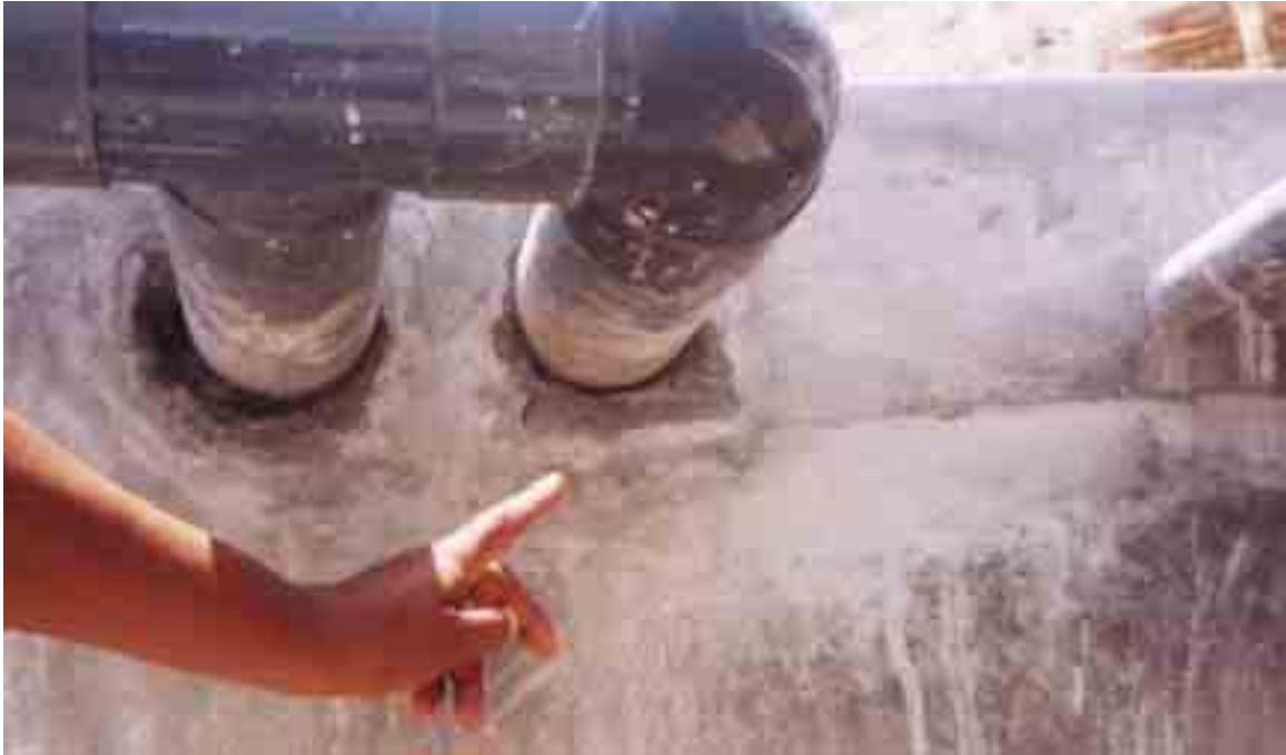
Foto10: Daños ocasionados a las tuberías de retorno.
