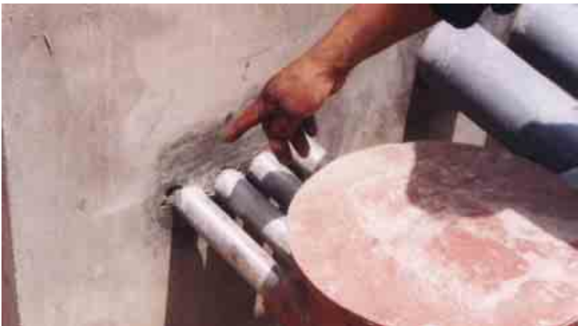
Fig. 11: Daños ocasionados a la salida de los tubos de enfriamiento.
