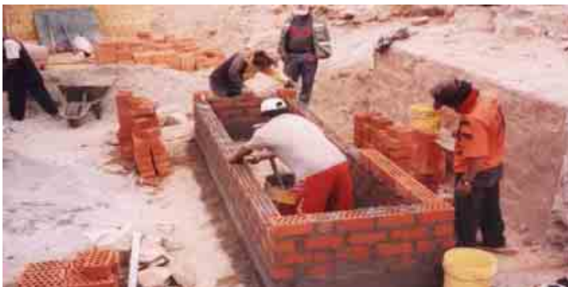
Foto 5: Inicio de la construcción de la retorta comunal, con la dirección técnica del Ingeniero del Grupo Consultor.
